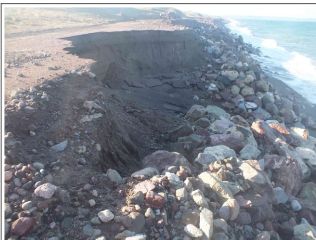
Effondrement entre la digue et la plateforme
