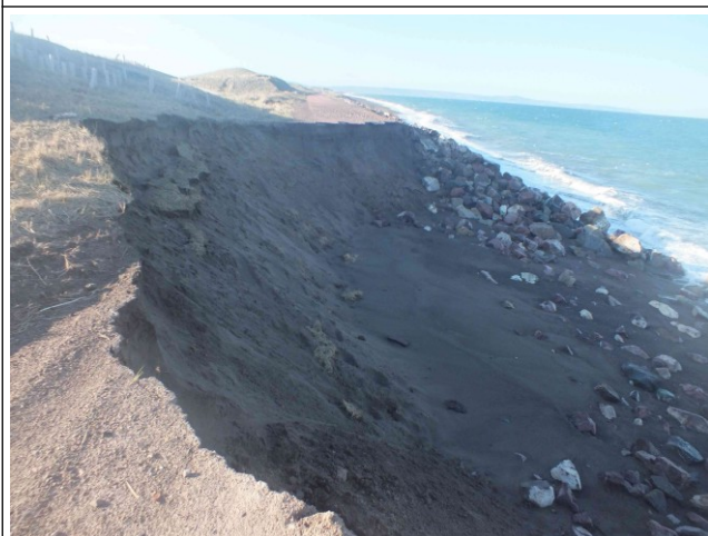
Evolution de l'effondrement sur la plateforme
