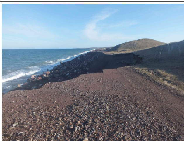
Vue de la chaussée du même effondrement
