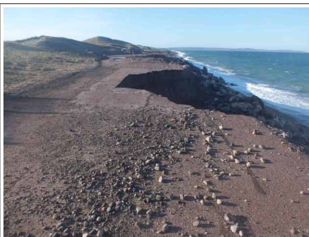
Vue de la chaussée du même effondrement
